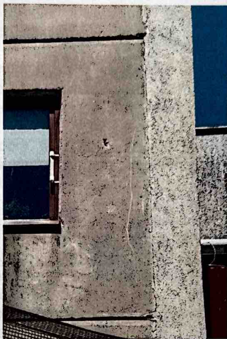
Fot. 2. Ubytek otuliny na wieszaku.
