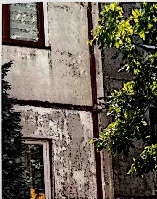
Fot. 1. Brak izolacji, przemieszczenie płyty.
